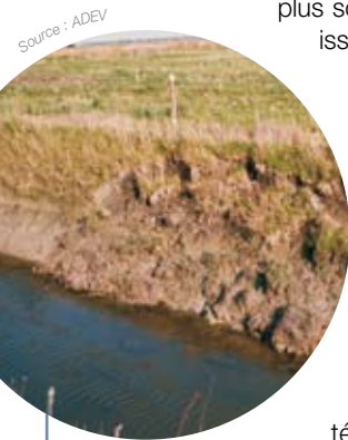
Source : ADEV Fig.10. Berges éboulées après un curage à blanc
