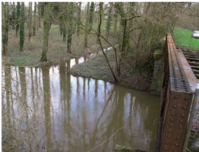
Rejet dans le Don au pied de l'ancien ouvrage SNCF de l'écoulement en provenance du nord-est de Treffieux
