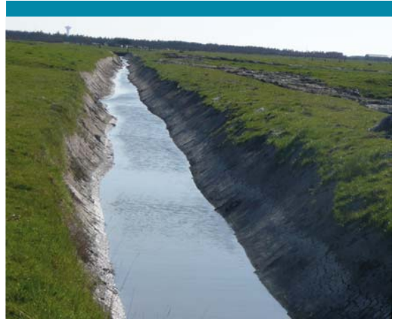
Les fossés rectilignes et profonds accélèrent l'écoulement des eaux vers l'aval et empêchent la zone humide de jouer son rôle d'expansion des crues profitable à l'épuration des eaux
