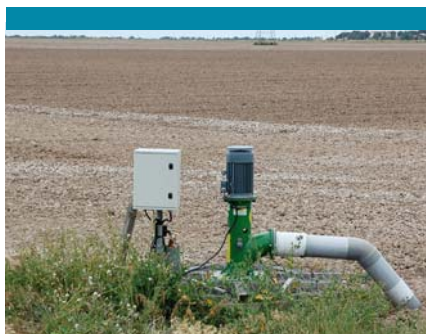
Pompage dans les masses d'eau
