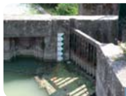
Règle limnimétrique sur un ouvrage en marais (source FMA).
