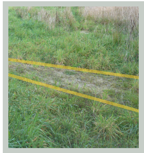
Mauvaise reprise de la végétation sur une tranchée (traits jaunes) rebouchée sans prendre en compte l'ordre naturel des horizons du sol. © FMA
