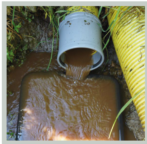
Transport de sédiments via un réseau de drainage enterré lors de l'amorce du drainage
